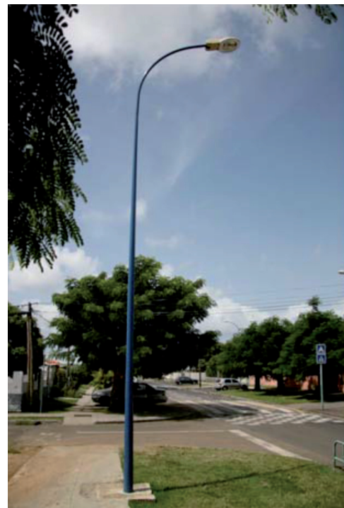
Modernisation de l'éclairage public
